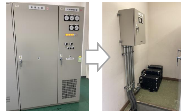
充電器盤＋蓄電池盤
