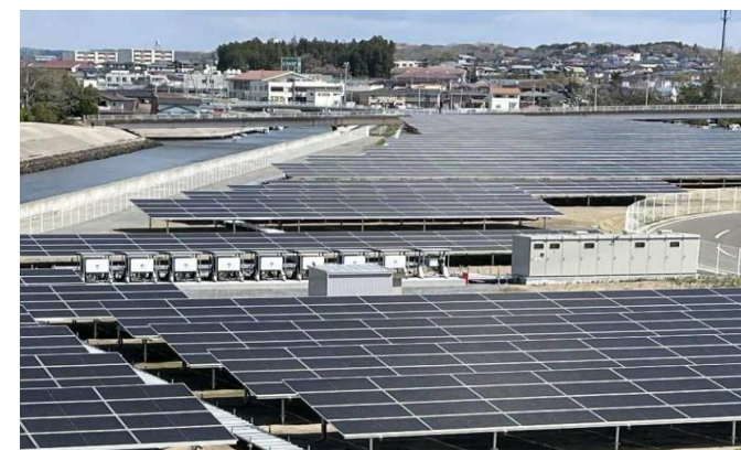
太陽光発電設備
