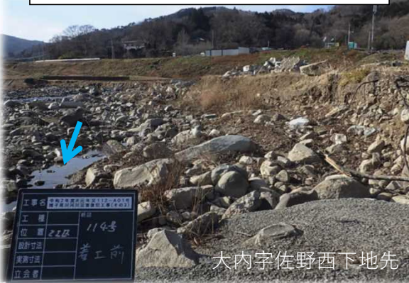
雫子尾川 元災 114号 被災状況
