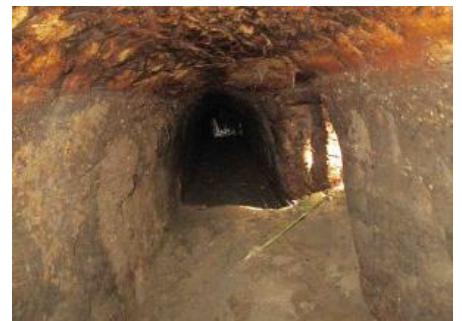
▲ 隧道の被災状況
