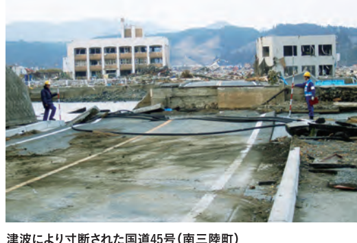
津波により寸断された国道45号(南三陸町)
