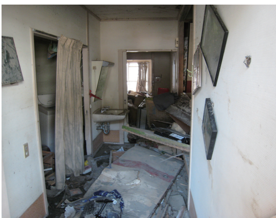
石巻吉野住宅被災状況
