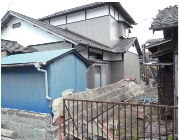
ブロック塀の倒壊
