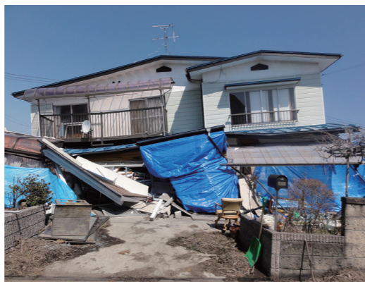
建築物の被災状況(仙台市)
