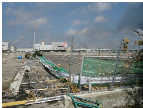
モータープールフェンス損壊
