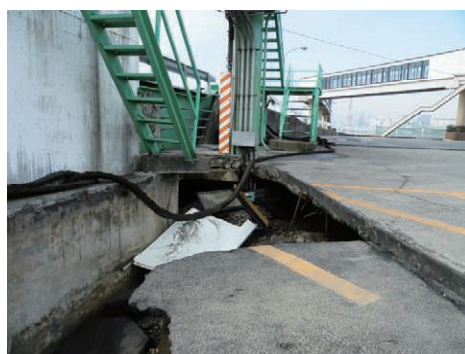
フェリーふ頭岸壁損壊
