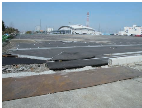
モータープール舗装損壊
