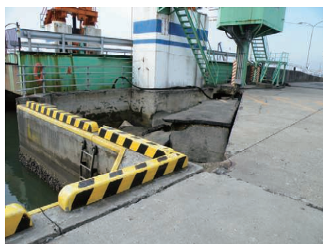
フェリーふ頭岸壁損壊
