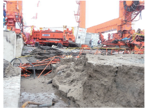
ガントリークレーン基部破損
