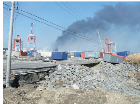
臨港道路損壊
