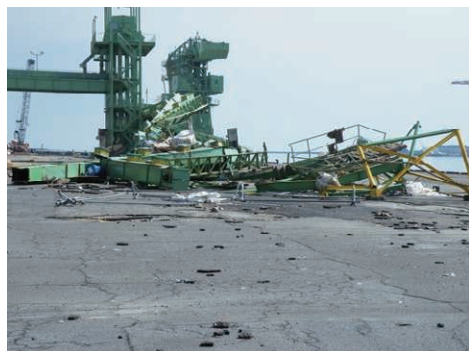
中野ふ頭 1号岸壁 アンローダー倒壊
