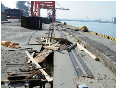
ガントリークレーンレール破損
