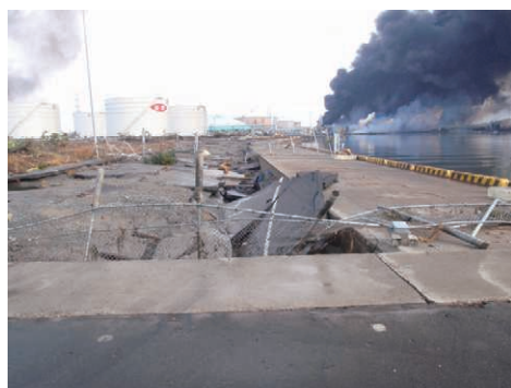
栄地区護岸損壊
