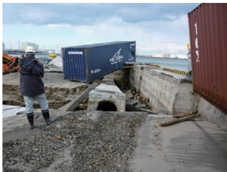
高砂ふ頭取付部沈下
