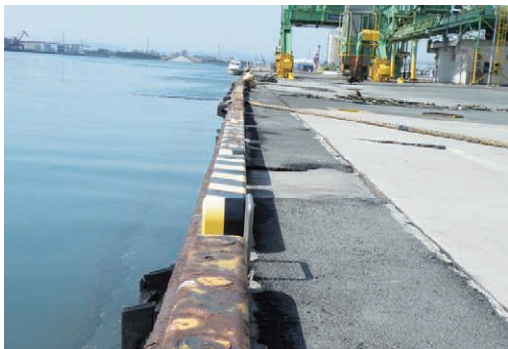
中野ふ頭 1号・2号岸壁 被災状況
