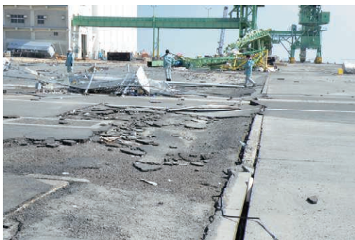
中野ふ頭 2号岸壁 被災状況
