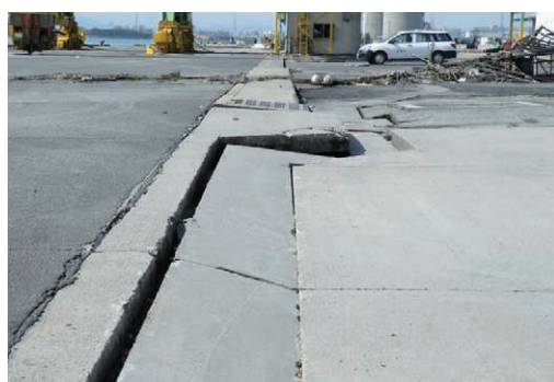
中野ふ頭 1号岸壁 被災状況
