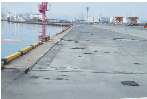
中野ふ頭 5号・6号岸壁 被災状況
