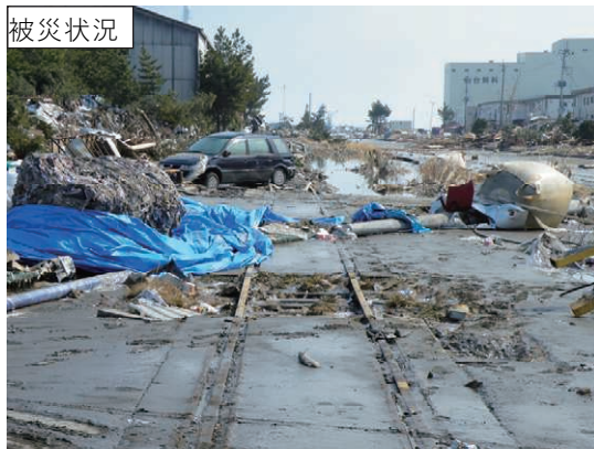
中央ふ頭線 被災状況
