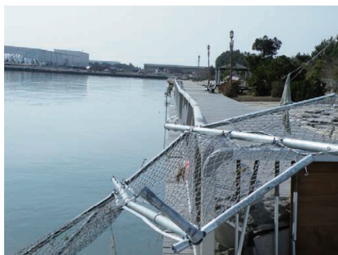
中央公園 被災状況
