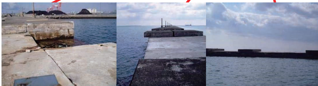
南防波堤 被災状況
