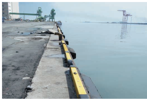
中野ふ頭 3号・4号岸壁 被災状況
