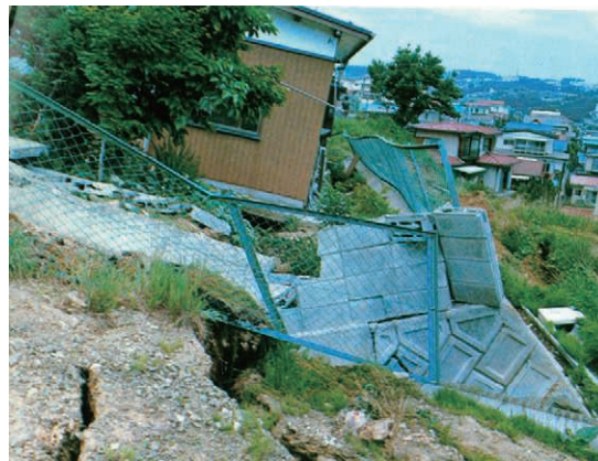
倒壊した住宅団地（仙台市）
