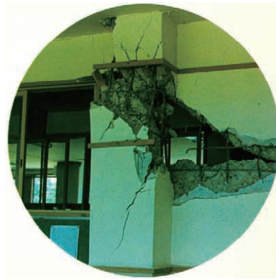
鉄筋コンクリート柱がせん断亀裂（仙台市）
