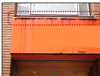
その他（塗装剥離、腐食など）
