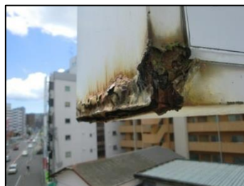
側板の腐食が進行した状態
