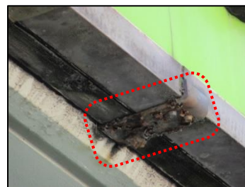
金具が劣化した状態
