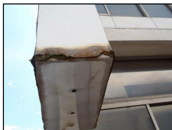
側板の腐食が進行した状態
