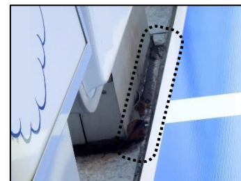
コーキングが劣化した状態
