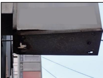
側板底面が腐食、破損、変形した状態
