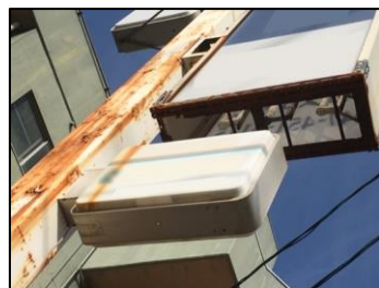
支柱にさびが発生した状態
