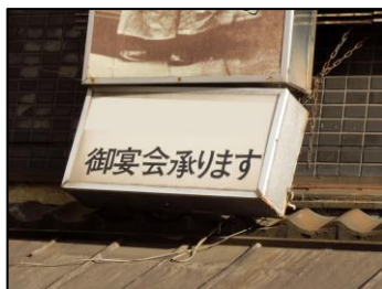
屋外広告物本体の傾き
