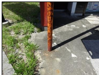
支柱の腐食が進行した状態
