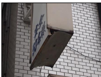
その他 （塗装剥離、腐食など）
