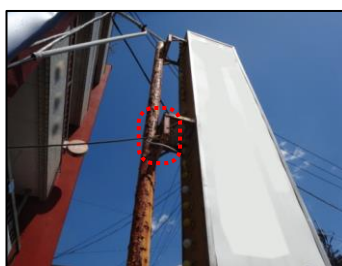
支柱・広告板接合部の腐食・隙間
