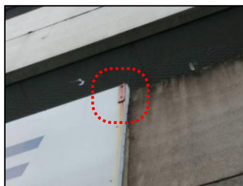
金具が劣化した状態
