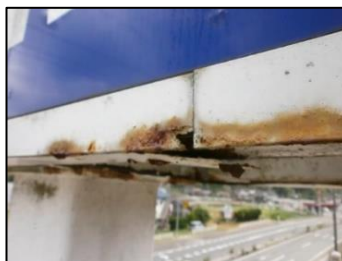
その他（塗装剥離、腐食など）
