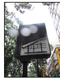
シート材がはがれかかった状態
