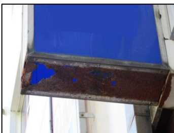
側板底面が腐食、破損した状態
