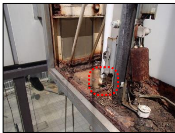
蛍光灯のホルダーが破損した状態
