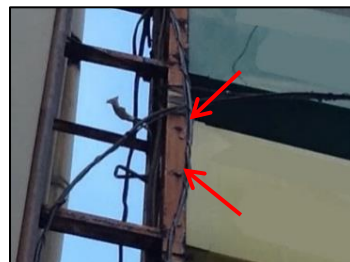
ボルトのゆるみや欠落した状態
