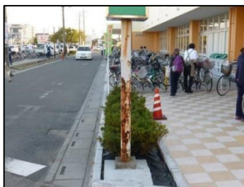
支柱の腐食が進行した状態
