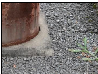
屋外広告物本体の傾き
