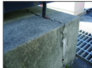
基礎にクラックが入った状態
