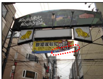
幕材を張る部材が破損した状態
