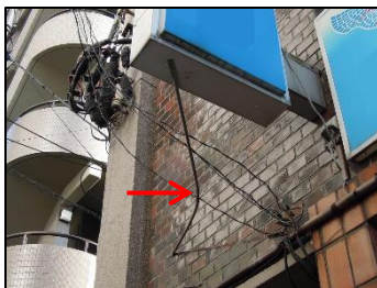
振れ止め棒が変形した状態
