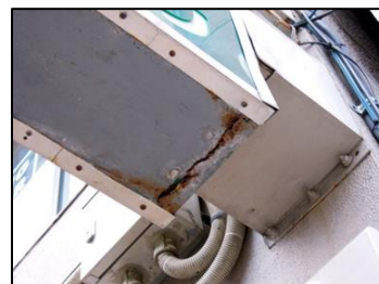
側板底面が破損した状態
