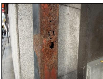
支柱の腐食が進行した状態
