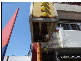
側板底面が欠損した状態
