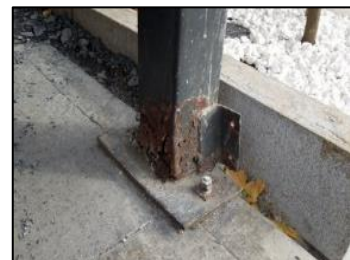
支柱根元の腐食が進行した状態
