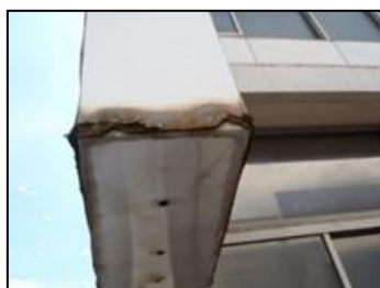
広告板底部の腐食
