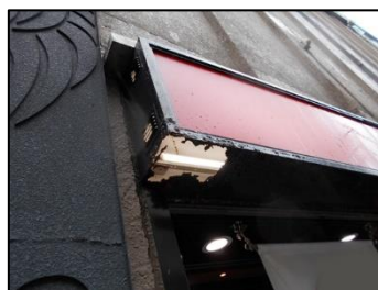
側板底面の腐食が進行した状態
