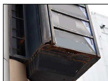
側板底面が腐食、破損した状態
