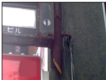
支持部が腐食した状態
