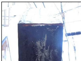
側板底面にさびが発生した状態
