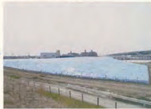
⑨仮設工(シート張工) 盛土工(覆土工)完了後、ブルーシート及び、土壌によるシート張工を実施
