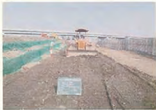
⑦盛土工(覆土工) ナイロンメッシュシート完了後、良質土にて覆土を実施
