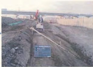
⑧盛土工(土羽土) 法面部(t=500)を粘性土にて土羽を実施
