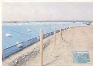
⑩仮設工(立入防止柵、土砂流出防止柵、素掘側溝) 盛土部周囲に立入防止柵、土砂流出防止柵、素掘側溝を設置
