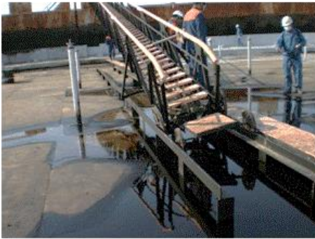
図 2.5.2 ローリンググラダーの脱輪
