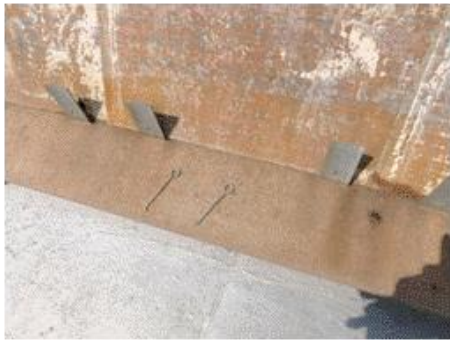
図 2.5.4 ウエザーシールのはずれ
