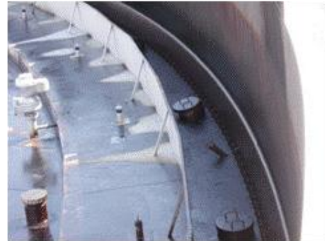
図 2.5.5 ポンツーン蓋の離脱
