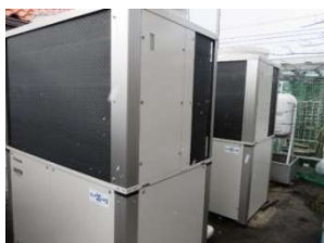
高効率空調機（室外機）
