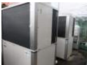
高効率空調機（室外機）
