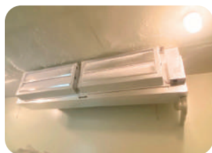
更新した省エネ設備
