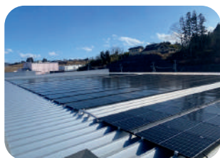
導入した太陽光発電設備
