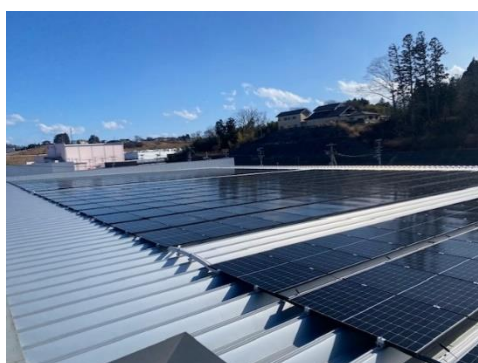
導入した太陽光発電設備
