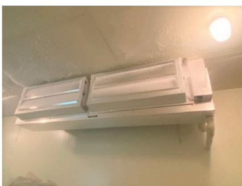
更新した省エネルギー設備
