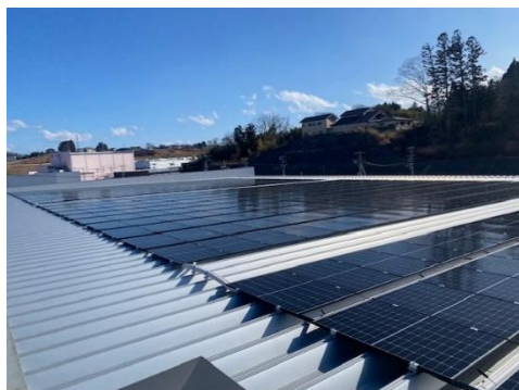
導入した太陽光発電設備
