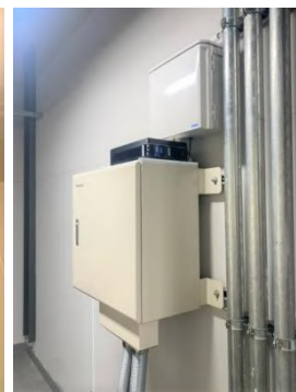
デマンド監視装置
