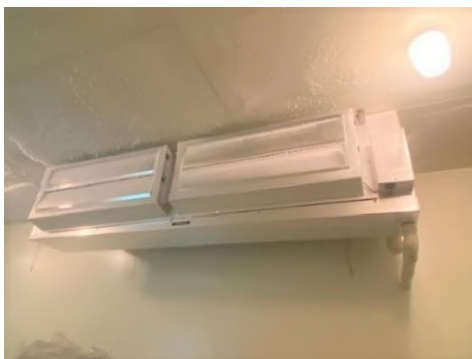
更新した省エネルギー設備
