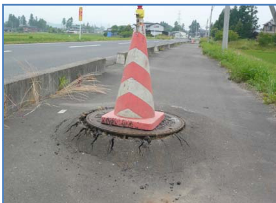
マンホールの隆起状況 (旧鶯沢町)
