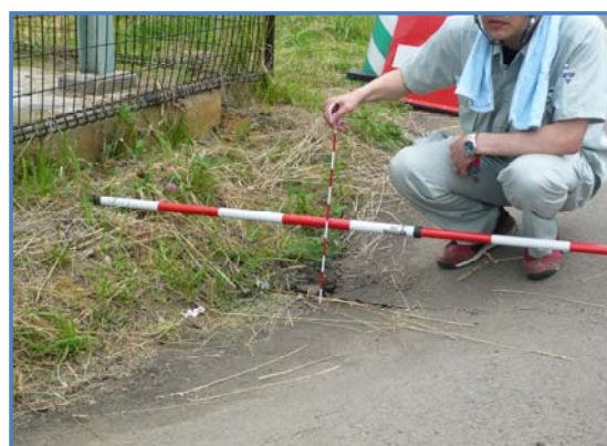
管きよ上の路面の沈下 (旧栗駒町・栗駒第2ポンプ場付近)
