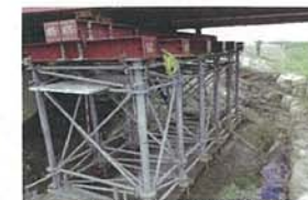
震災後の応急対策状況写真
