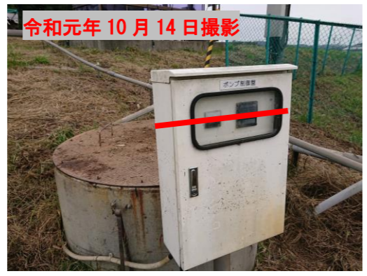
写真2 送水ポンプNo.1制御盤 (赤線: 浸水位置)
