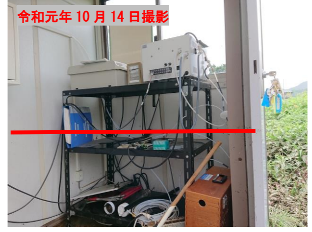
写真3 硫化水素ガスモニタリング機器浸水状況 (赤線: 浸水位置)
