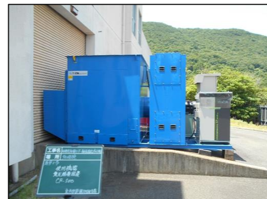
集じん設備(他事例)
