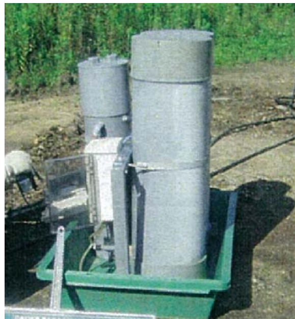
写真 2.1 ガス処理設備イメージ写真
