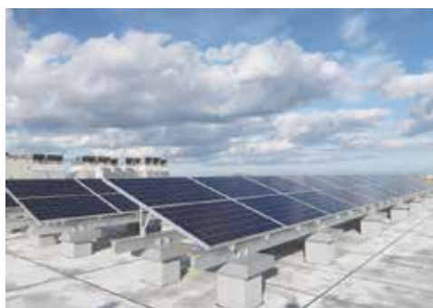
屋上に設置された太陽光発電設備
