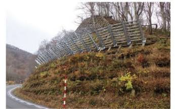
防雪柵対策の整備 [(国)347号 鍋越(加美町)]
