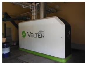
小型バイオマス発電施設
