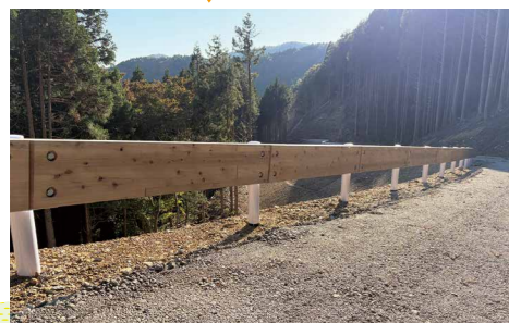
ガードレール
