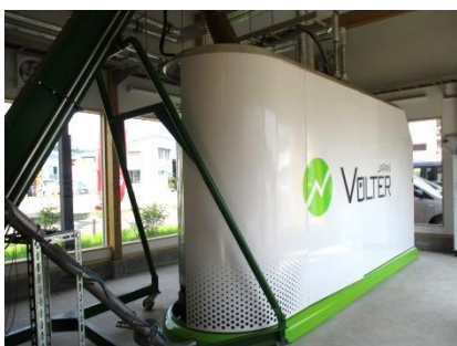
導入された超小型木質バイオマス発電
