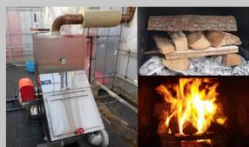
木質バイオマスボイラーと燃焼室での薪の燃焼状況(右)
