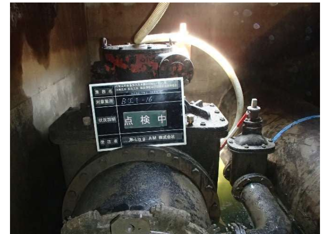
制水弁点検状況
