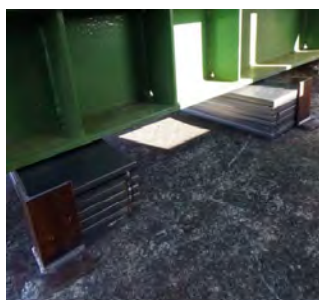
応急対策状況
