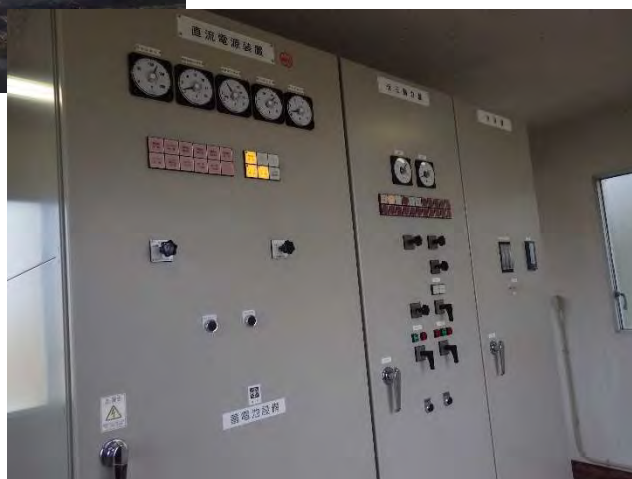
●テレメータ室内計器
