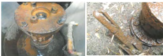
空気弁等の劣化や不具合状況(例)
