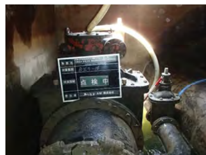
制水弁点検状況
