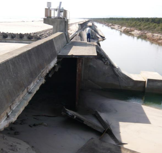
被災後（平成23年3月24日）
