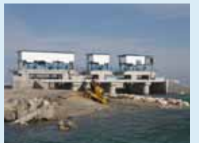
⑭防潮樋門被災状況 (山元町: 牛橋地区)
