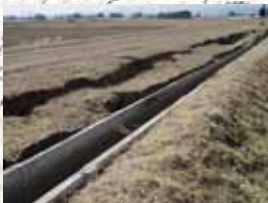
③農地被災状況 (大崎市, 加美町: 多田川左岸地区)
