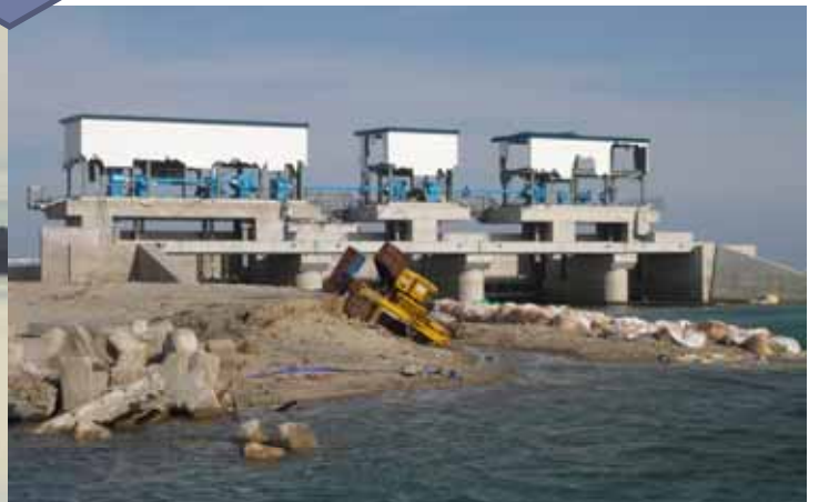
被災後の状況(平成23年4月1日15時20分頃)
