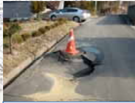
②農業集落排水被災状況 (登米市: 新小路地区)
