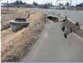
①かんがい排水被災状況 (栗原市: 迫川上流地区)
