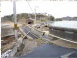
⑧海岸堤防被災状況 (松島町: 駒形・新田海岸堤防)
