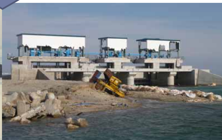
被災後の状況(平成23年4月1日15時20分頃)
