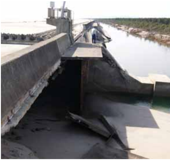
被災後(平成23年3月24日)
