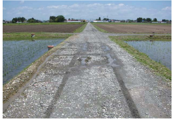
▲写真 漏水の状況
