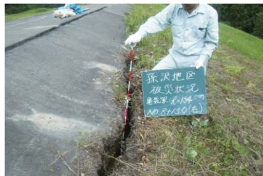
▲写真 堤体の亀裂
