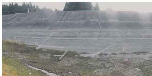
▲写真 舗装の破損状況
