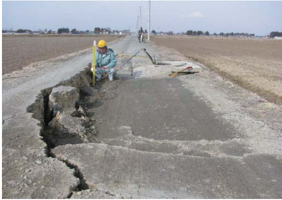
▲写真 道路の破損状況コース
