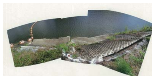
▲写真 被災状況
