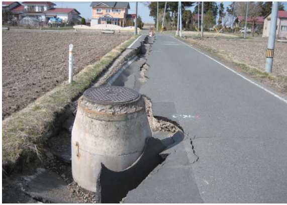
▲写真 マンホールの隆起
