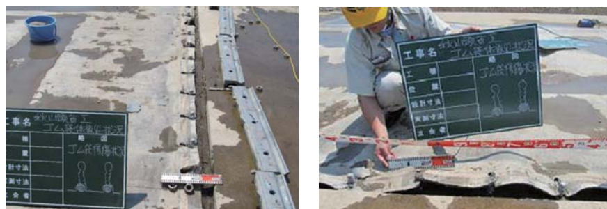
▲写真 破損状況
