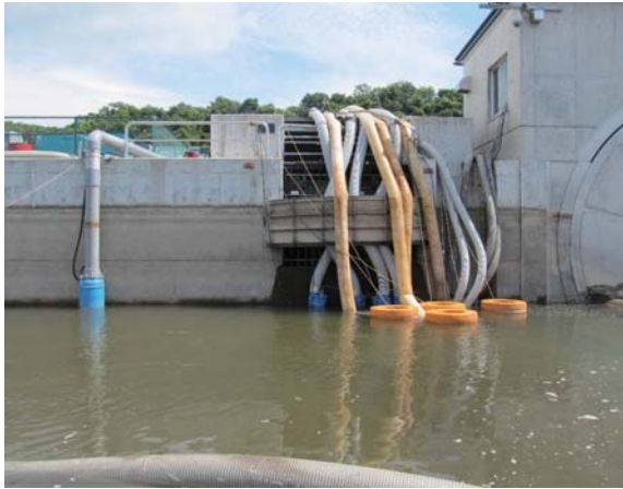
▲写真 応急用水手当ポンプ設置状況
