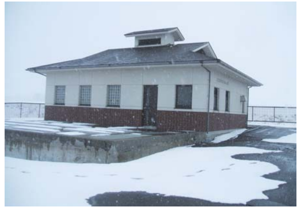
▲写真 建屋の傾き
