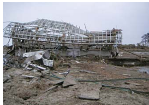
▲写真 山下第8揚水機場（山元町）
