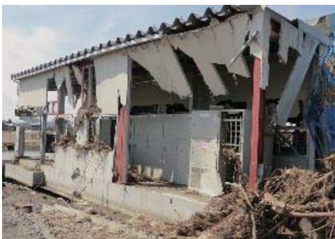
▲写真 大畑浜排水機場（亘理町）
