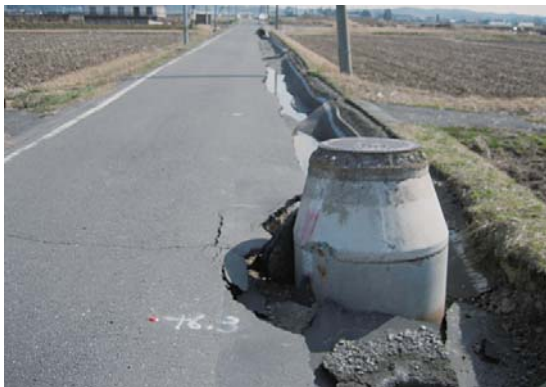
▲写真 農業集落排水管路施設の被災状況 (大崎市高柳地区)
