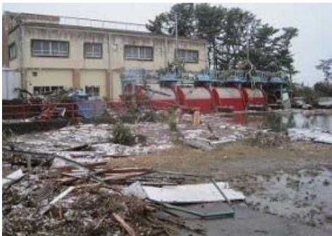
▲写真 関上排水機場（名取市）
