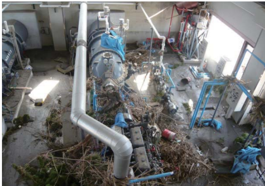
▲写真 被災直後の排水機場 (H23. 3)
