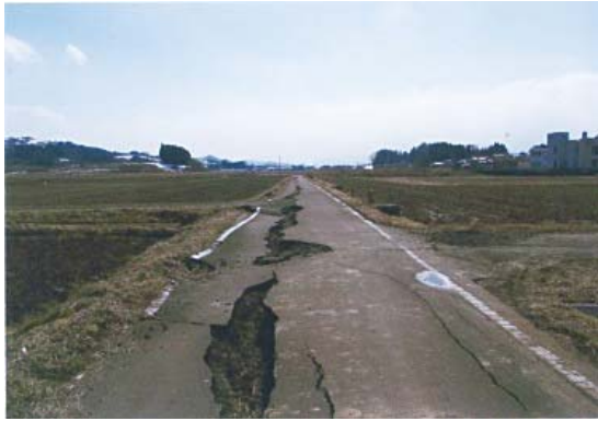
▲写真 農道の被災状況(蔵王町和田(1)地区)
