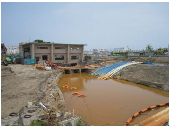
▲写真 高砂南部排水機場（仙台市）
