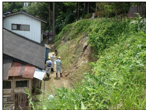
【若柳】小館の1（急傾斜地崩壊危険箇所）
