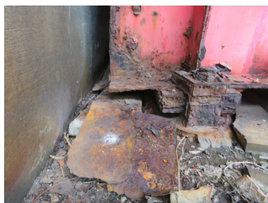
支承部の腐食
