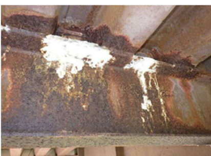
横桁部の腐食
