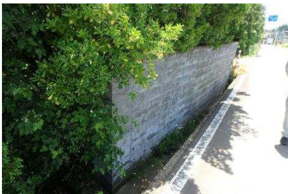
上写真)危険と判定されたブロック塀
