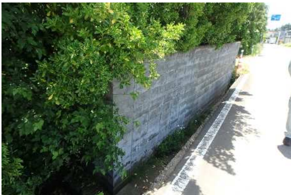
上写真)危険と判定されたブロック塀等
