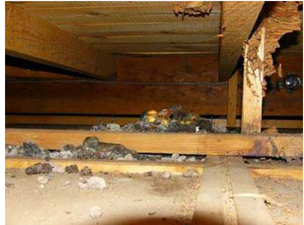
天井裏のフン被害
