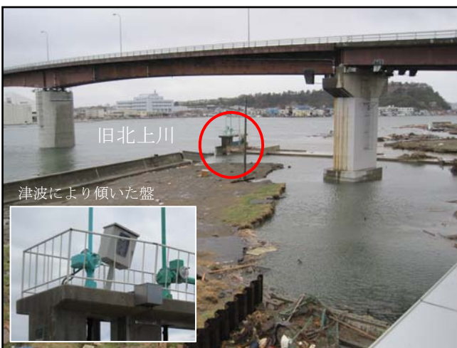
被災状況（H23.4.19）
