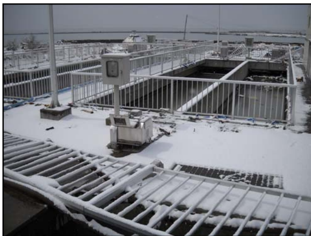
被災状況（H23.3.17撮影）
