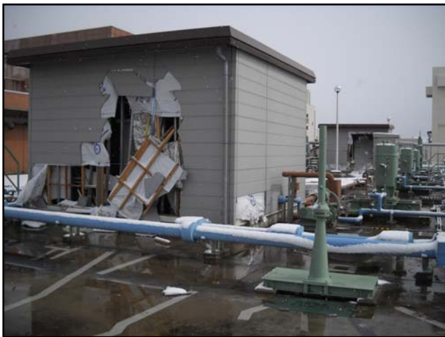
被災状況（H23.3.17撮影）
