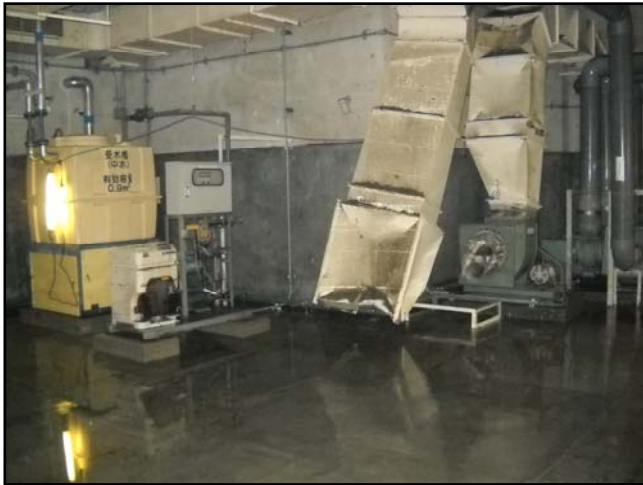
被災状況 (H23.5.26 撮影)
