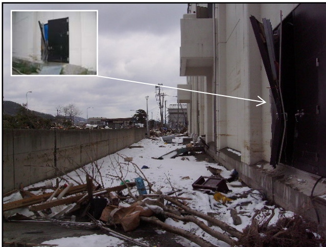
被災状況 (H23.3.18 撮影)
