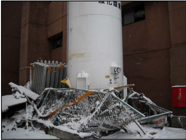
被災状況 (H23.3.17 撮影)
