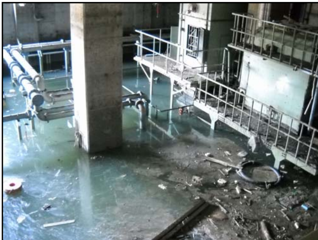
被災状況 (H23.3.17 撮影)
