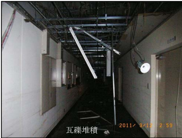
被災状況 (H23.3.12 撮影)
