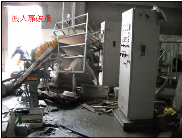
被災状況 (H23.3.17 撮影)
