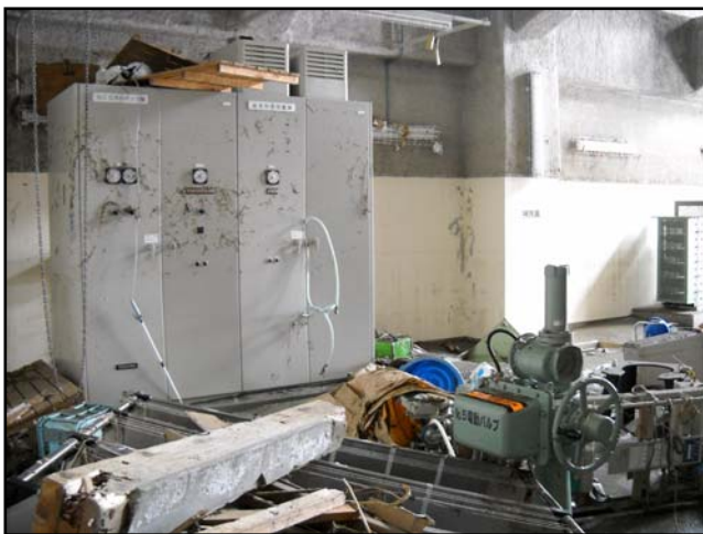
被災状況 (H23.3.17 撮影)
