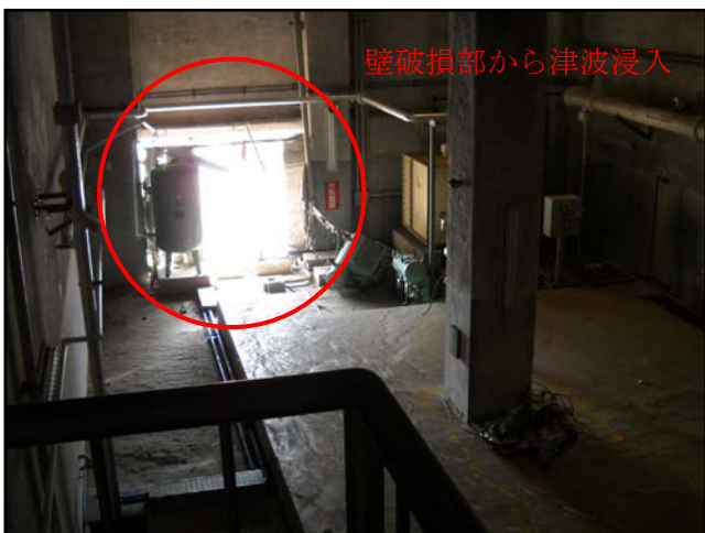
被災状況 (H23.3.17 撮影)
