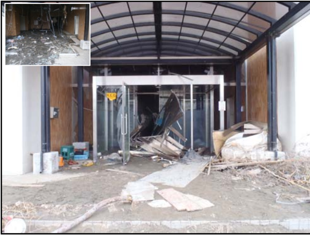
被災状況 (H23.3.24 撮影)
