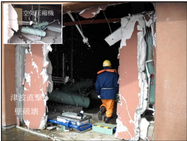
被災状況 (H23.3.17 撮影)
