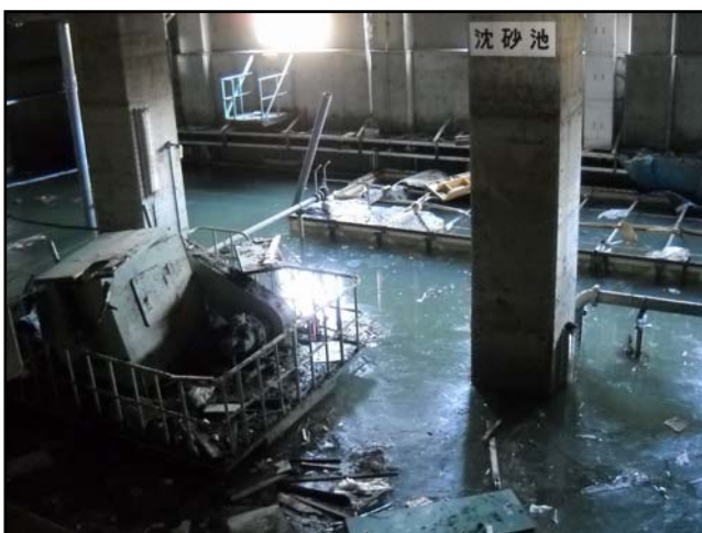
被災状況 (H23.3.17 撮影)
