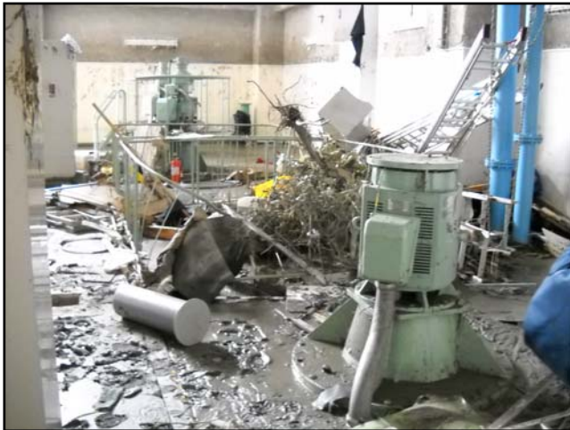
被災状況 (H23.3.17 撮影)
