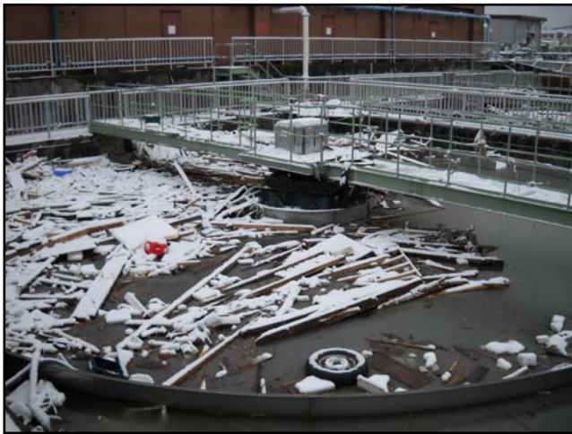
被災状況 (H23.3.17 撮影)
