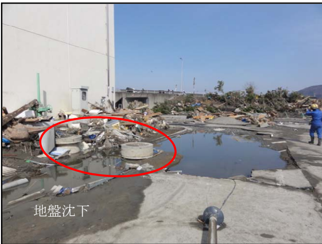
被災状況（H23.3.14撮影）
