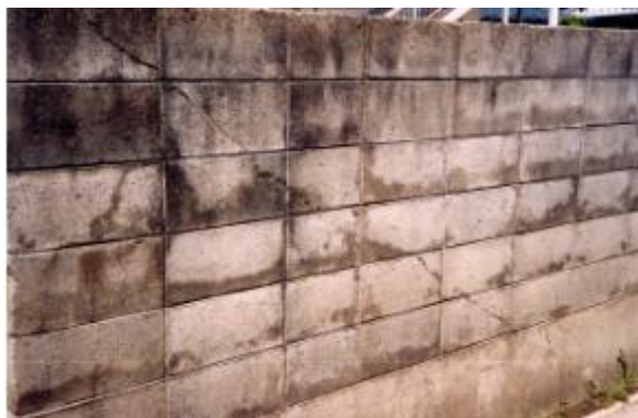
↑斜めに大きなひび割れが入っている
