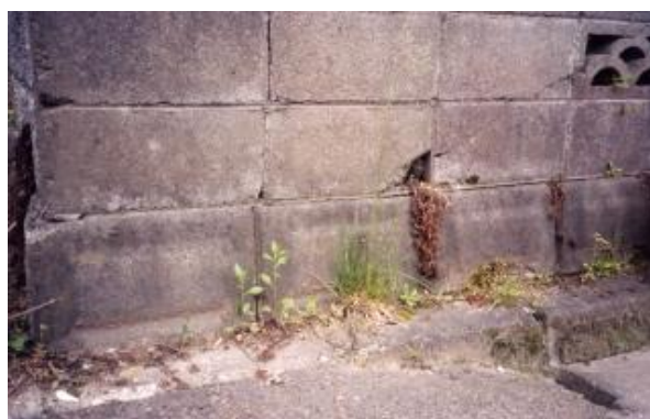
↑下部にひび割れもあり、ずれも生じている
