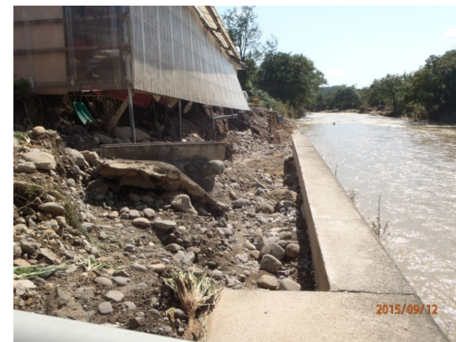
泉区根白石 年川橋下流左岸 (平成27年9月関東・東北豪雨)
