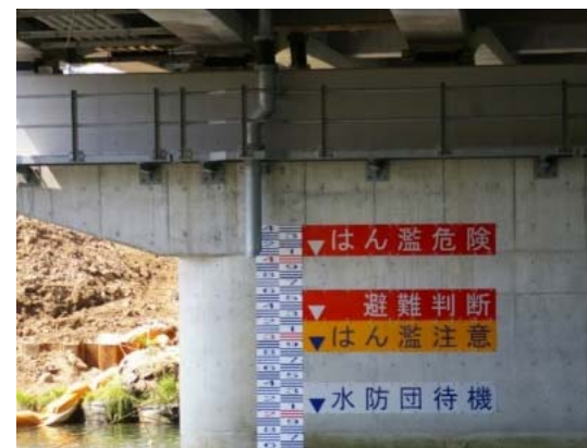
橋脚への水位表示例
