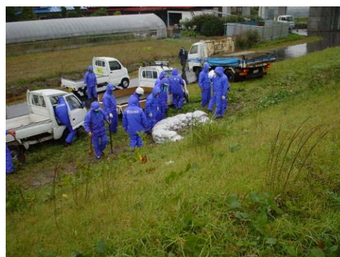
写真 2-24 漏水による水防活動の状況
