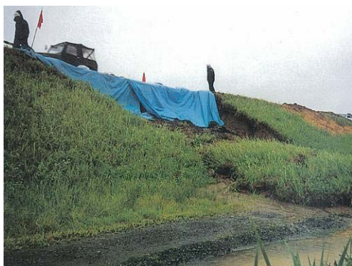
写真 2-23 堤防法崩れの状況
