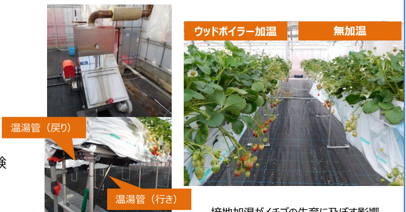
ウッドボイラー「S-220NSB」(上) 栽培槽への温湯管設置状況(下) 培地加温がイチゴの生育に及ぼす影響 (撮影：令和4年3月3日、設定温度15℃)
