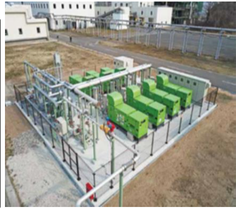
仙塩浄化センター 消化ガス発電所
