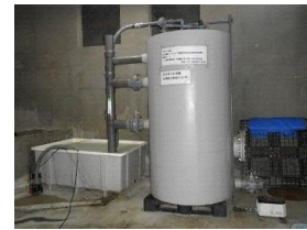
排水浄化処理槽
