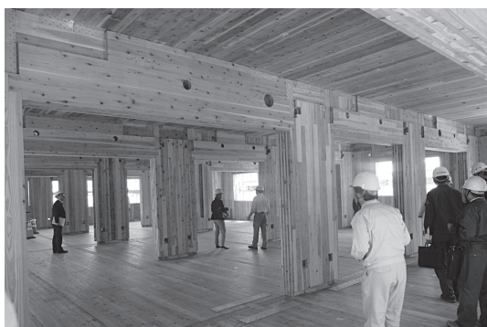
▲ CLTを活用した施設 (株)コスモスウェブ新社屋
