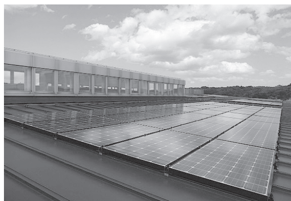
※写真（県警察機動センター設置の太陽光発電設備）
